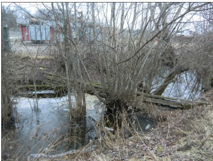
Figur 14. Träbeklädd gjutjärnsledning som löper tvärs över Knivstaån ca 75 m nedströms Knivstavägen.
